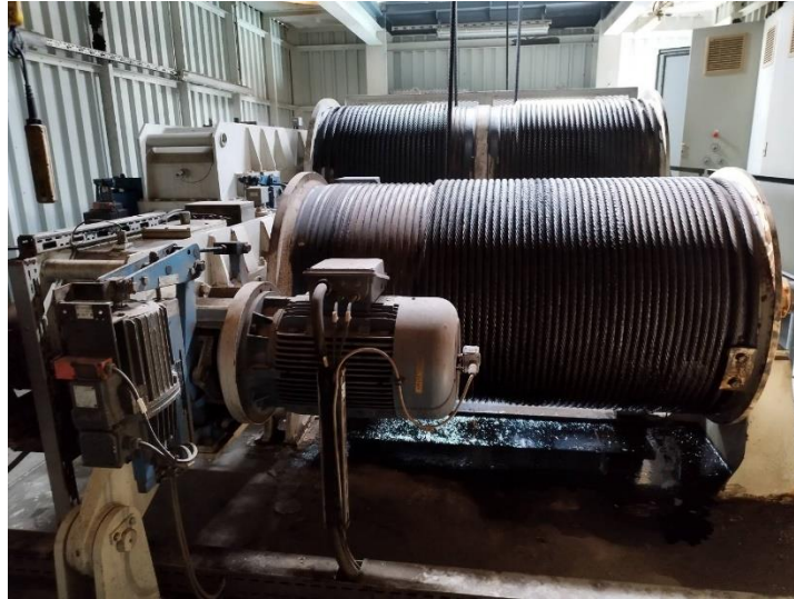
รูปที่ ๙ Gear Motor ขับสลิง Hoist 75 ton และ Hoist 50 ton
