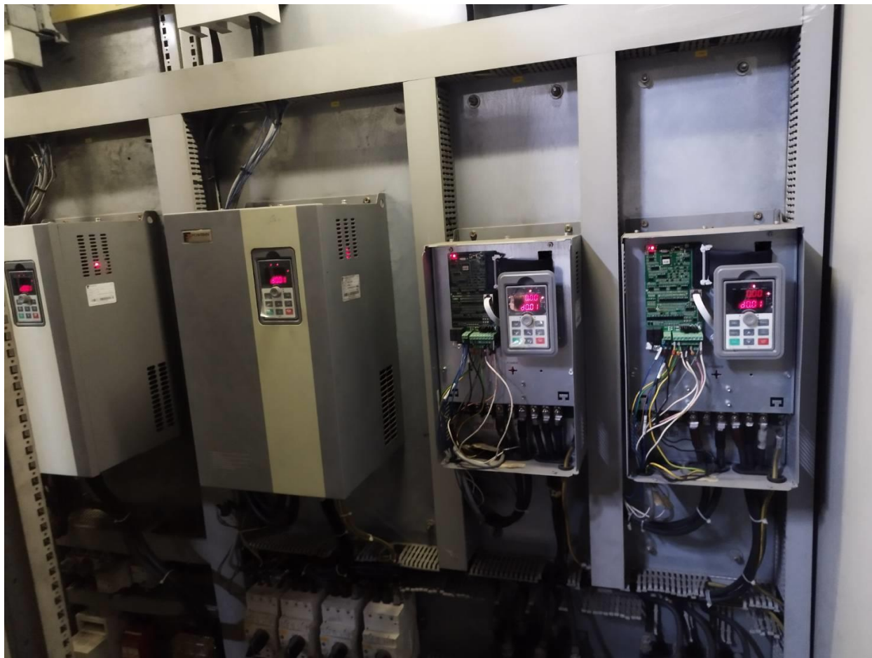
รูปที่ ๕ Inverter
